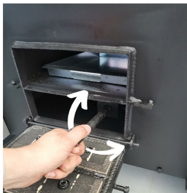
Figura 25. Curățarea tubulaturii cazanului
