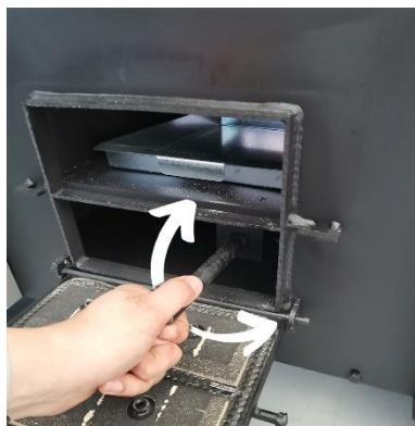
Figura 25. Curățarea tubulaturii cazanului
